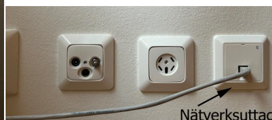
Installerat nätverksuttag med ansluten nätverkskabel.
